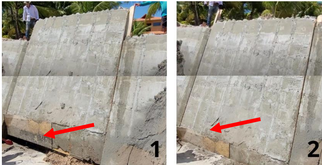
Figura 7 – Afundamento da Placa
