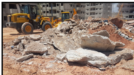
Figura 05: Desperdício de concreto
