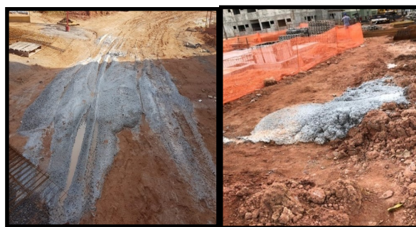
Figura 04: Sobra de concreto no Cocho da bomba hidráulica não aproveitada
