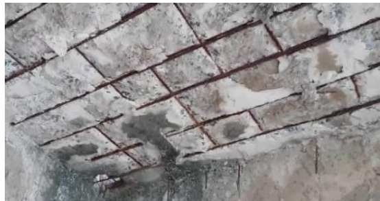
Figura 09: Fundo de uma laje no processo corrosivo
