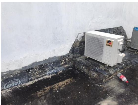
Figura 12: Manta colada no reboco.
