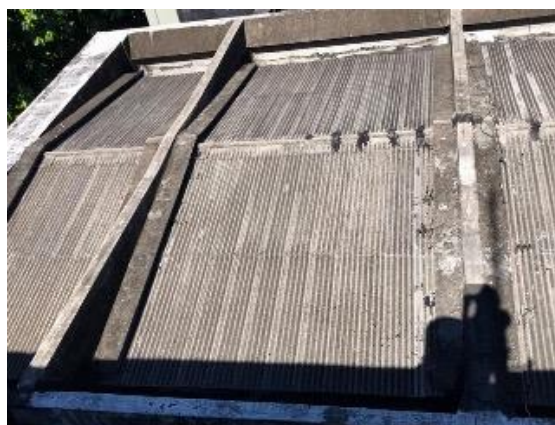
Figura 14: Ausência de impermeabilização sobre estrutura de concreto.
