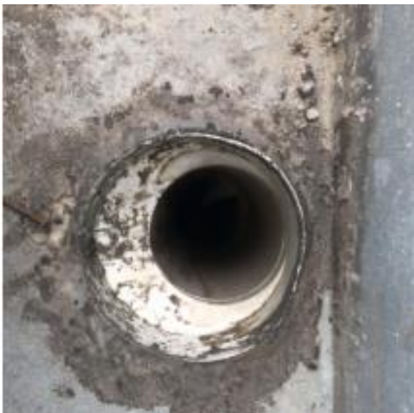
Figura 18: Ralo não impermeabilizado.
