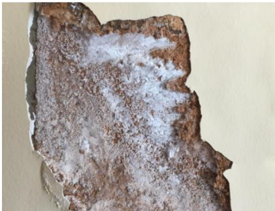
Figura 11: Camada de acabamento sendo desagregada.
