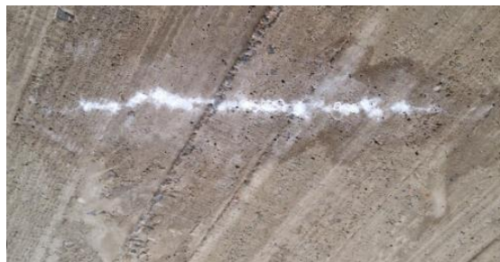
Figura 10: Eflorescência no fundo da laje.
