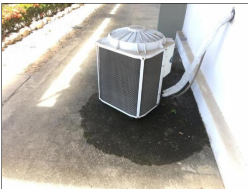
Figura 3 - Água condensada gerada por aparelho condicionador de ar sendo desperdiçada
