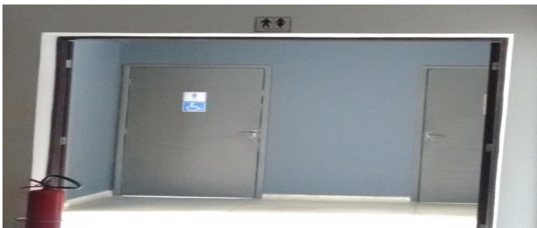
Figura 4 — Banheiros acessíveis para cadeirantes, sem indicação em Braille
