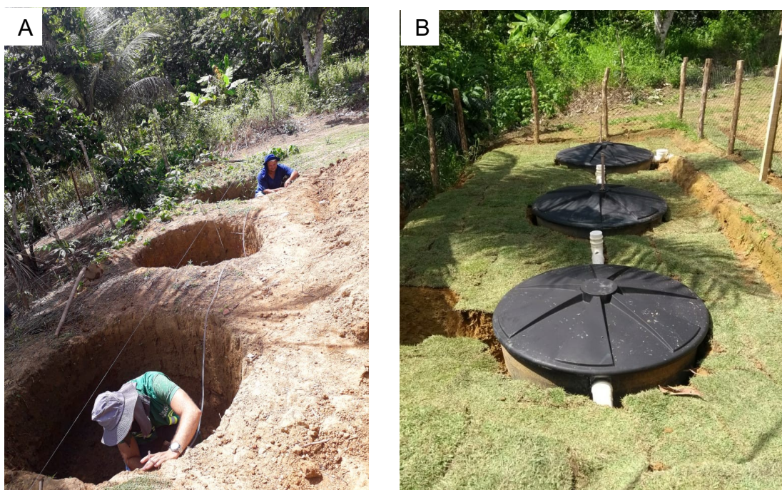
Figura 6. Escavação da área para assentamento do sistema (A) e fossa séptica biodigestora instalada (B)
