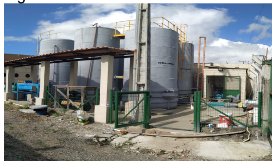
Figura 1: ETE do Hotel
