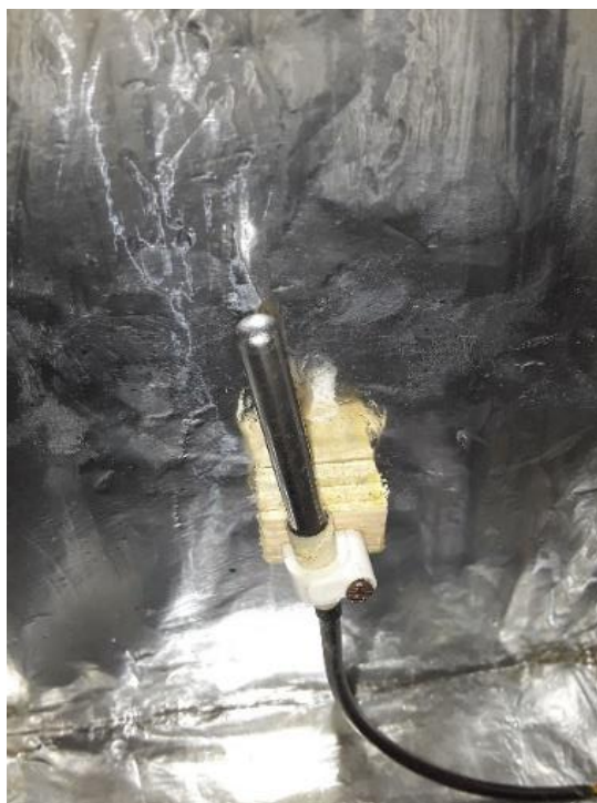
Figura 7 - Sensor de temperatura no interior da estufa.
