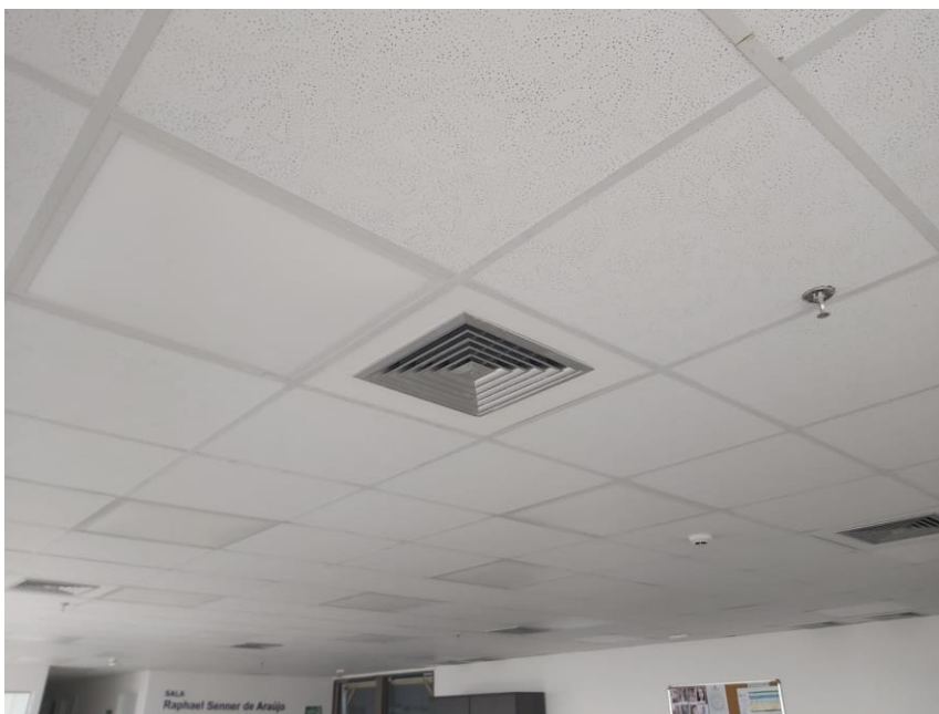
Figura 13: Sistema de ar-condicionado do tipo central instalado no CRQ-1
