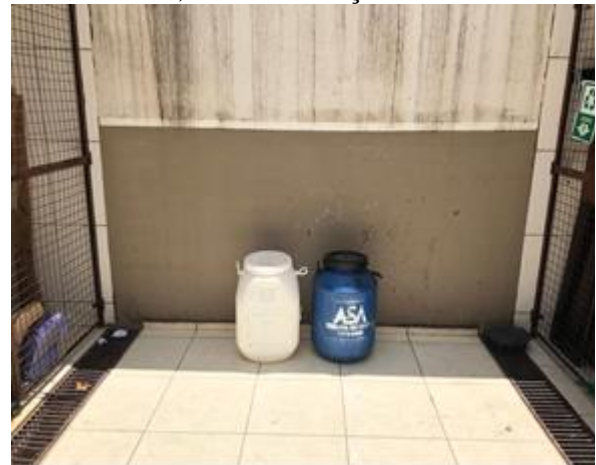
Figura 11 – Bombonas destinadas ao descarte de óleo, sem sinalização indicativa.
