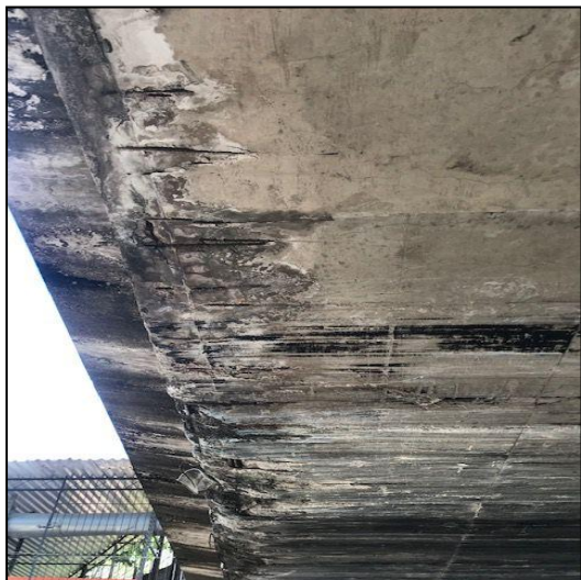
Figura 20 - Ferragens negativas do tablado aparente da Laje da Estrutura Nível “B”
