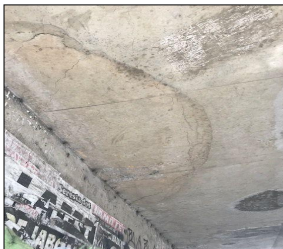
Figura 21 - Eflorescência no tablado do Viaduto na Laje da estrutura Nível “A” (Laje da Parte Inferior)
