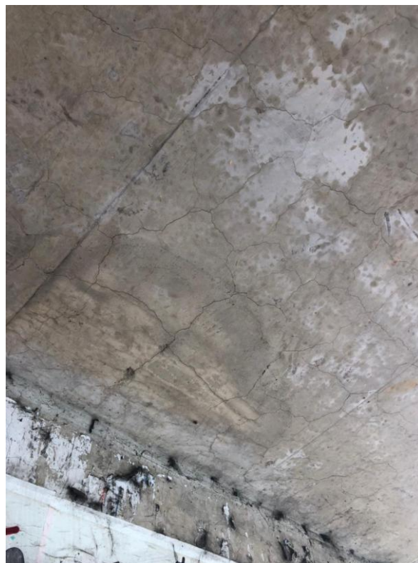
Figura 24 - Fissuras no tablado do Viaduto
