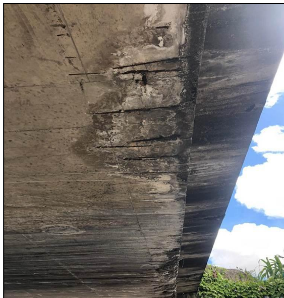
Figura 25 - Deslocamento do Concreto
