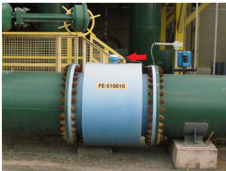
Figura 11 – Medidor de vazão magnético da RNEST
