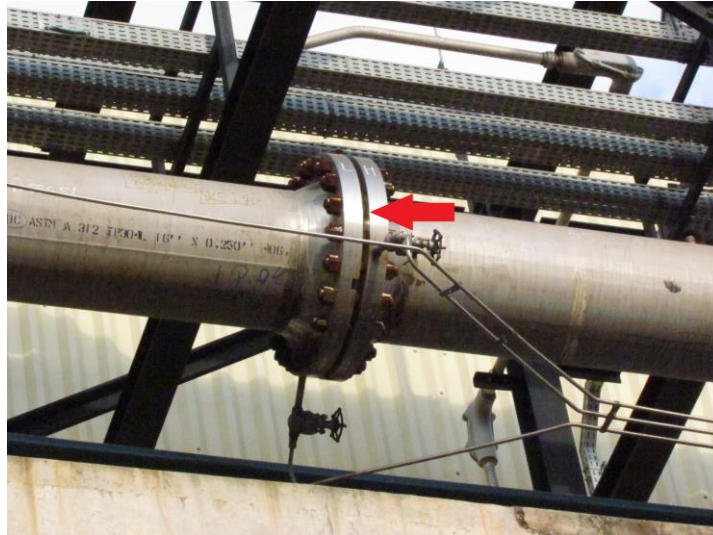
Figura 9 – Instrumento primário de vazão do tipo Placa de Orifício da RNEST
