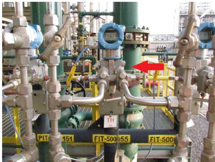
Figura 10 – Transmissor e Indicador de vazão do tipo Diferencial de Pressão
