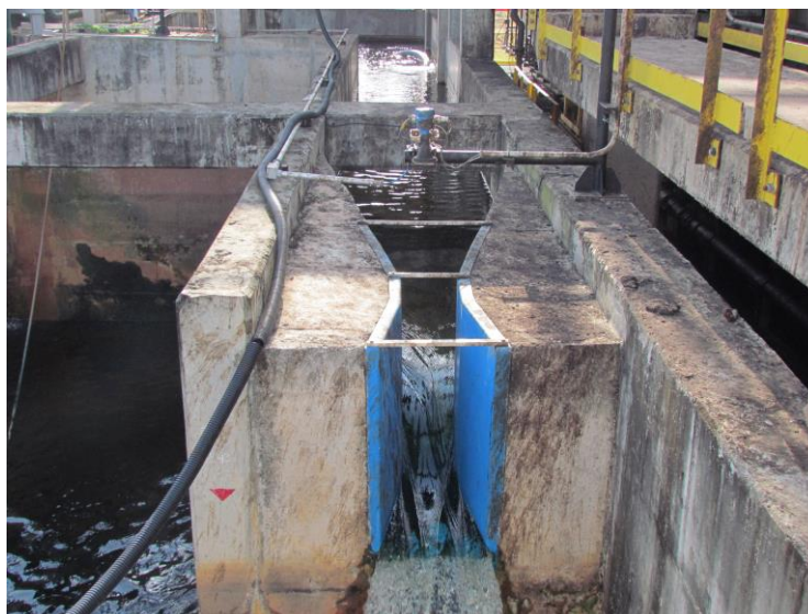
Figura 12 – Instrumento de vazão da RNEST em estrutura do tipo Calha Parshall
