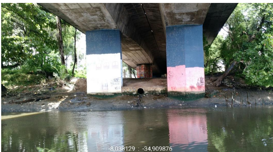
Figura 73 – Despejo de Esgoto abaixo do Viaduto da Torre, Recife
