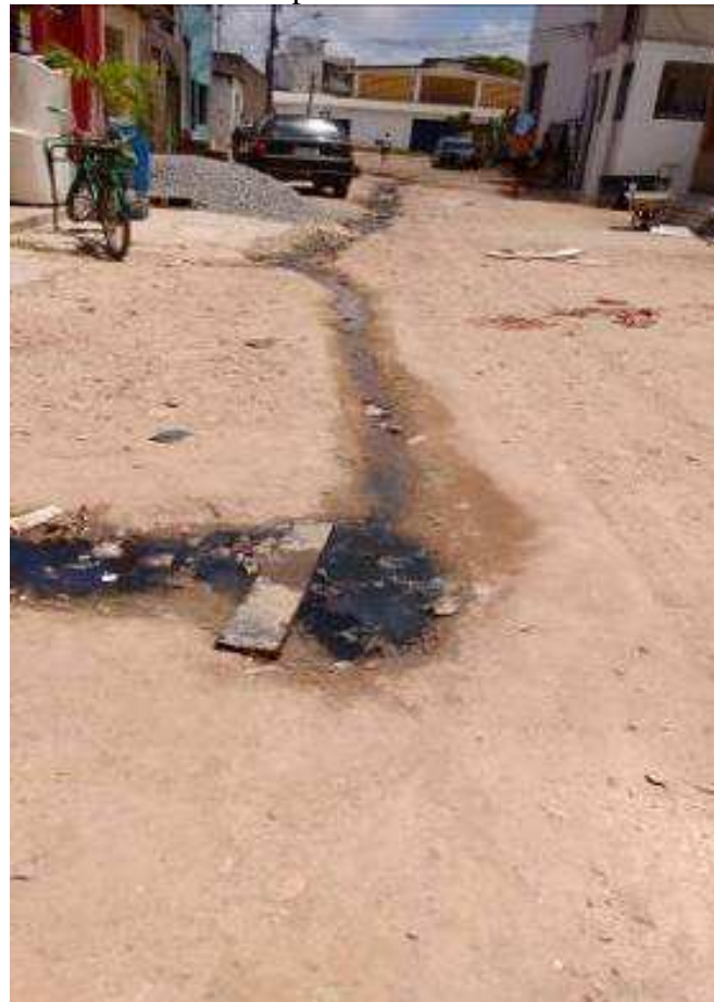
Figura 7 - Ausência de esgotamento na comunidade obrigando que os resíduos estejam expostos na rua
