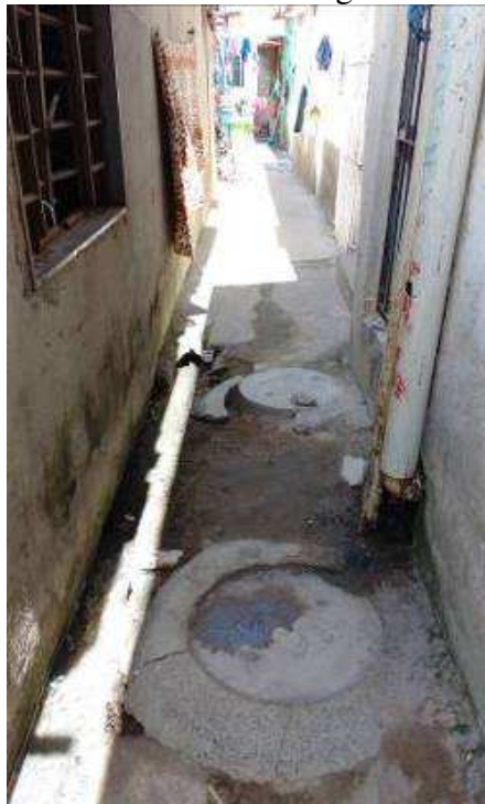
Figura 10 - Instalações e tubulações da Compesa já existem, mas, como não há estação elevatória, não há fornecimento de água e nem esgotamento.
