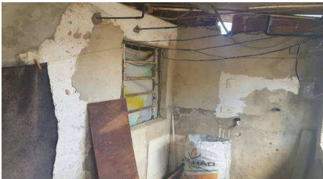
Figura 44 - Antiga casa da primeira família beneficiada com iniciativa de novas moradias. Uma casa muito precária, com vazamentos, infiltrações, problemas elétricos e hidráulicos.
