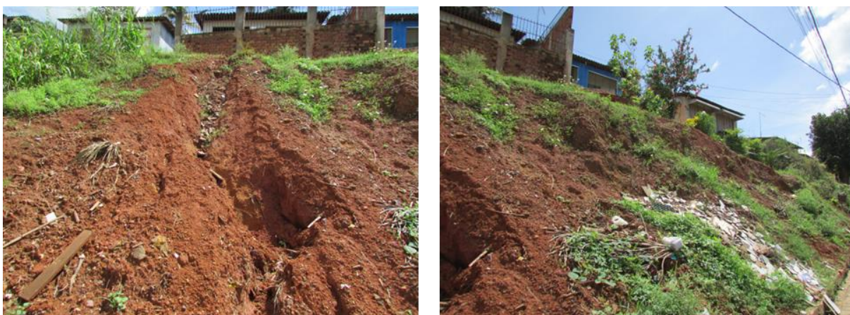
Figura 10 – Barreira exposta com construções irregulares, no município de São Lourenço da Mata - PE, 2019
