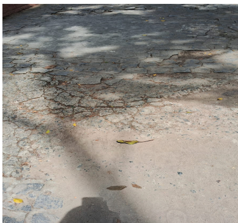
Figura 1 - Condições críticas de acessibilidade
