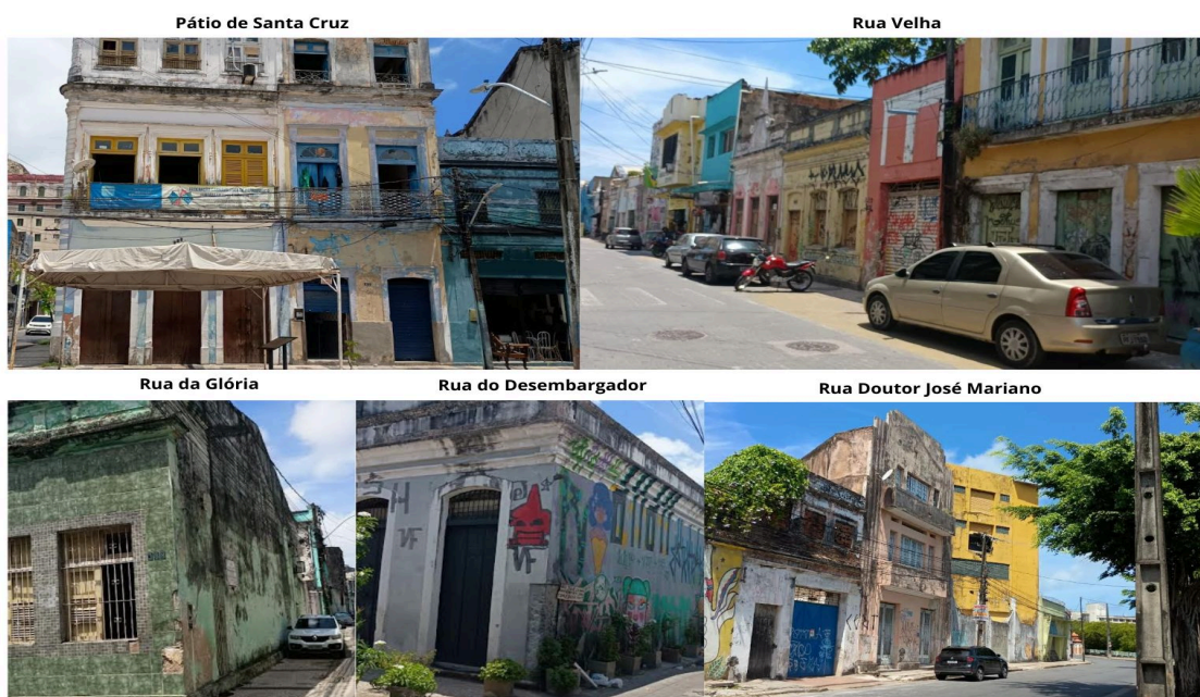
Figura 05 – Espaço do estudo – degradação
