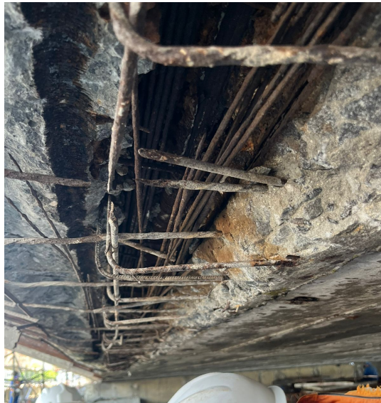
Figura 6 – Cordoalhas rompidas devido ao severo processo de oxidação da Ponte Giratória.
