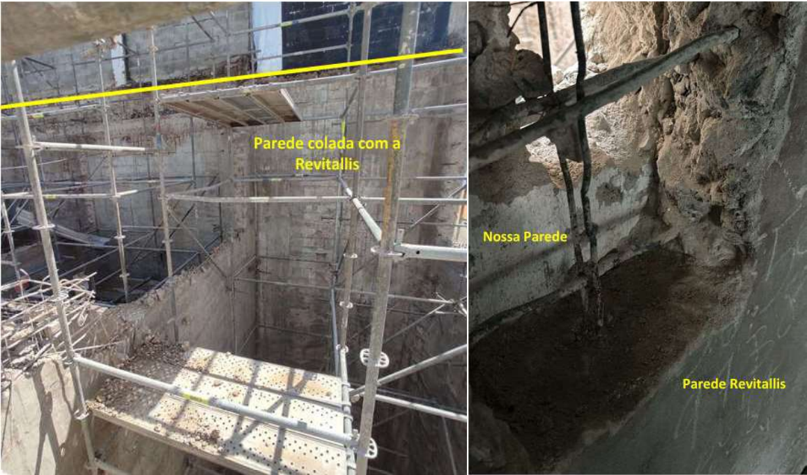
Figura 20: Parede dos Silos colada com a edificação vizinha
