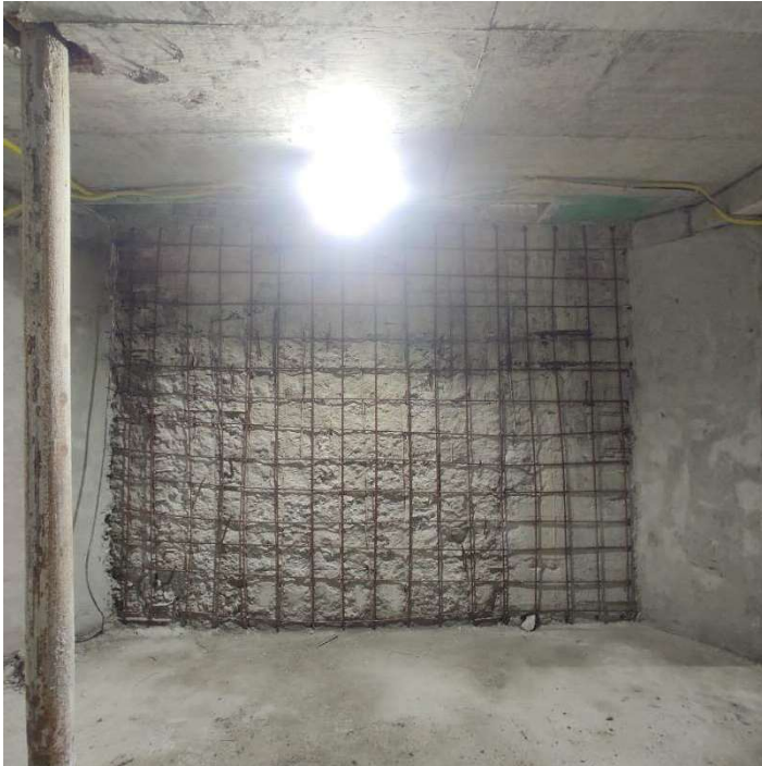
Figura 30: Parede com segregação de concreto reforçada para ser grauteada
