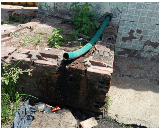
Figura 1 – Saída inadequada de efluente na comunidade
