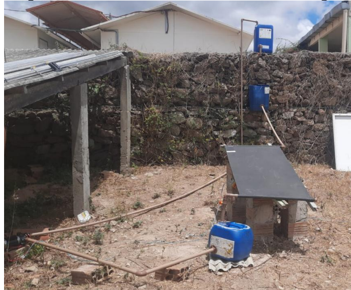
Figura 8 – Sistema de resfriamento de água
