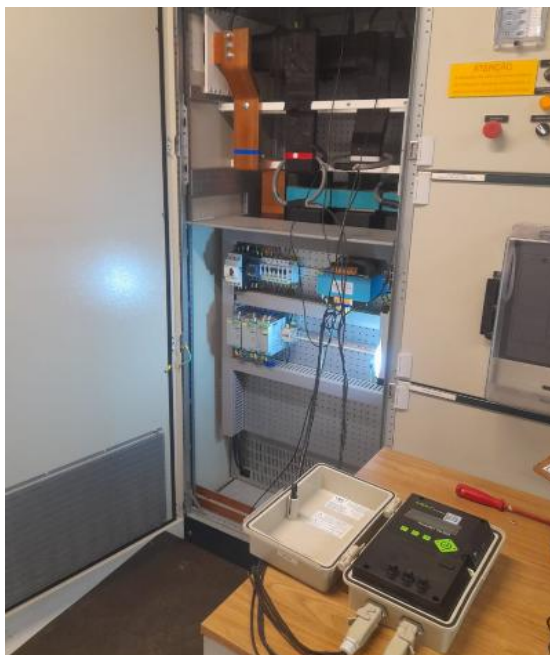
Figura 8 – Medições Elétricas no Barramento Principal.
