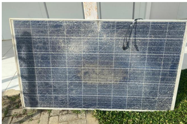
Figura 16– Módulo danificado utilizado na segunda substituição.
