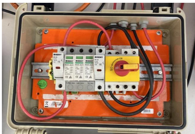
Figura 11– Caixa de Proteção CC do Sistema Fotovoltaico
