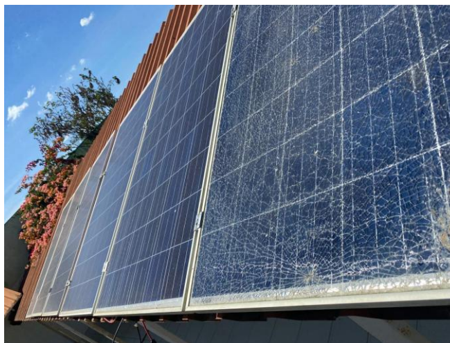
Figura 15– Arranjo Fotovoltaico com o primeiro módulo danificado instalado.
