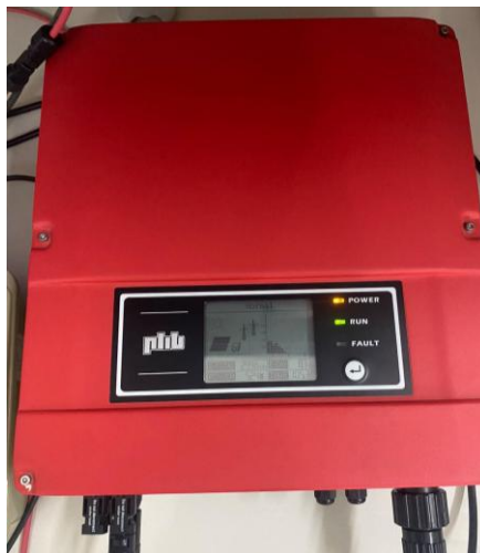
Figura 13 – Inversor Fotovoltaico PHB3000-SS
