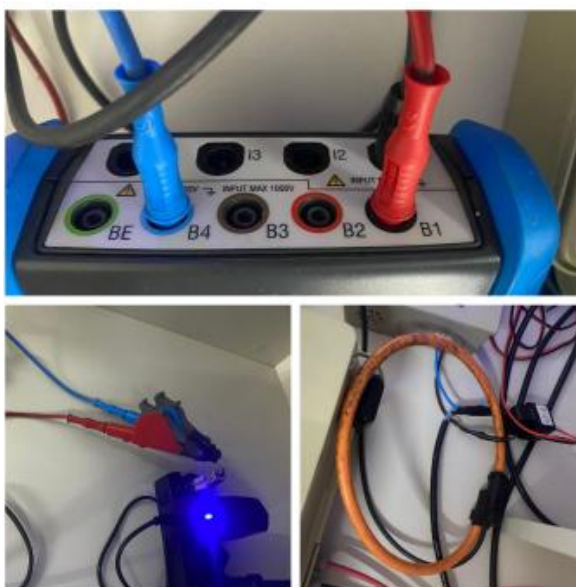
Figura 20– Conexões do equipamento ao sistema fotovoltaico
