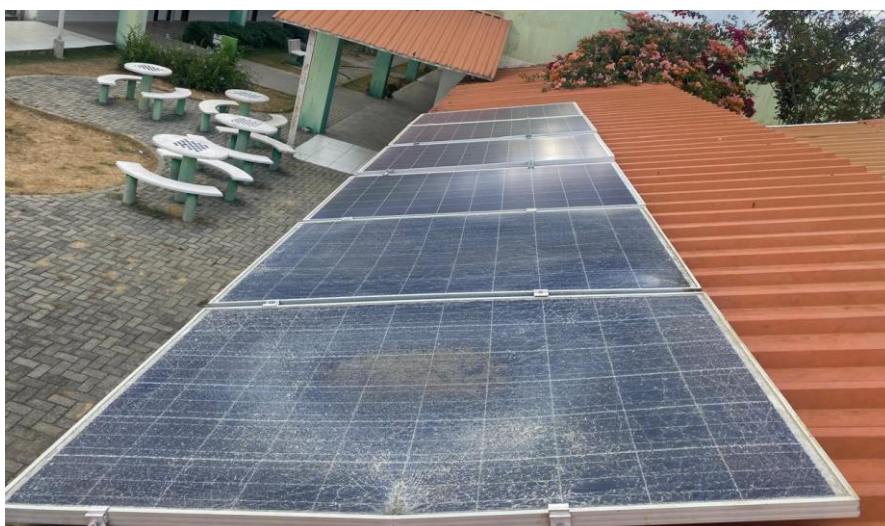
Figura 17– Arranjo Fotovoltaico com os dois módulos danificados instalados.
