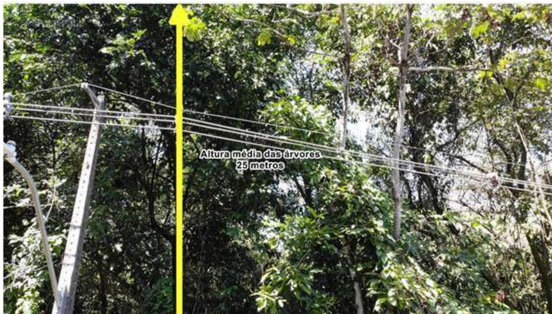
Imagem 32. Monitoramento de Conflito da rede elétrica com a vegetação. Estruturas Vão – 07
