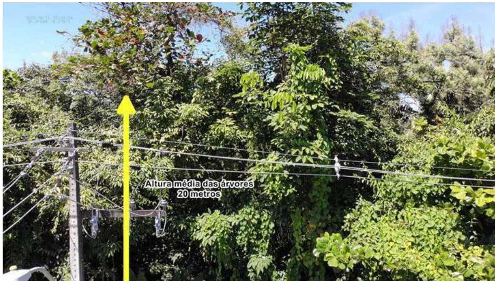
Imagem 26. Monitoramento de Conflito da rede elétrica com a vegetação. Estruturas Vão - 01
