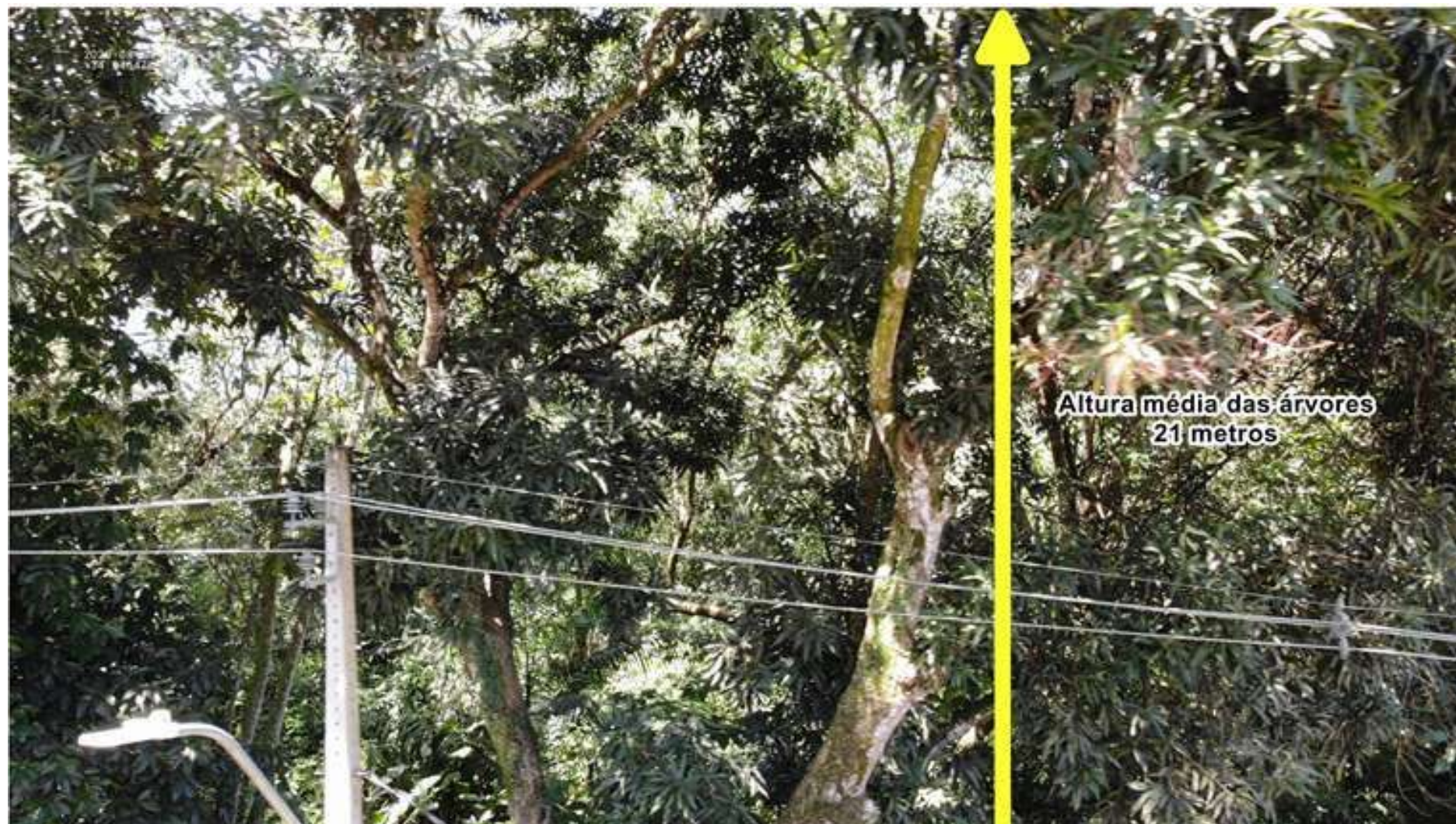
Imagem 29. Monitoramento de Conflito da rede elétrica com a vegetação. Estruturas Vão - 04
