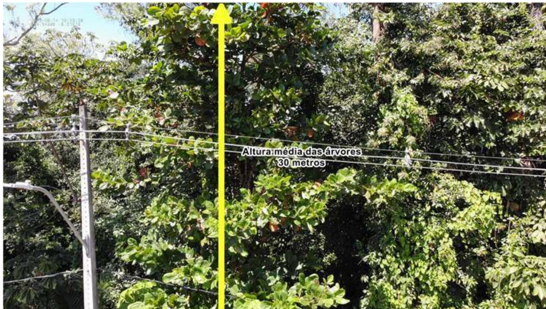
Imagem 27. Monitoramento de Conflito da rede elétrica com a vegetação. Estruturas Vão - 02
