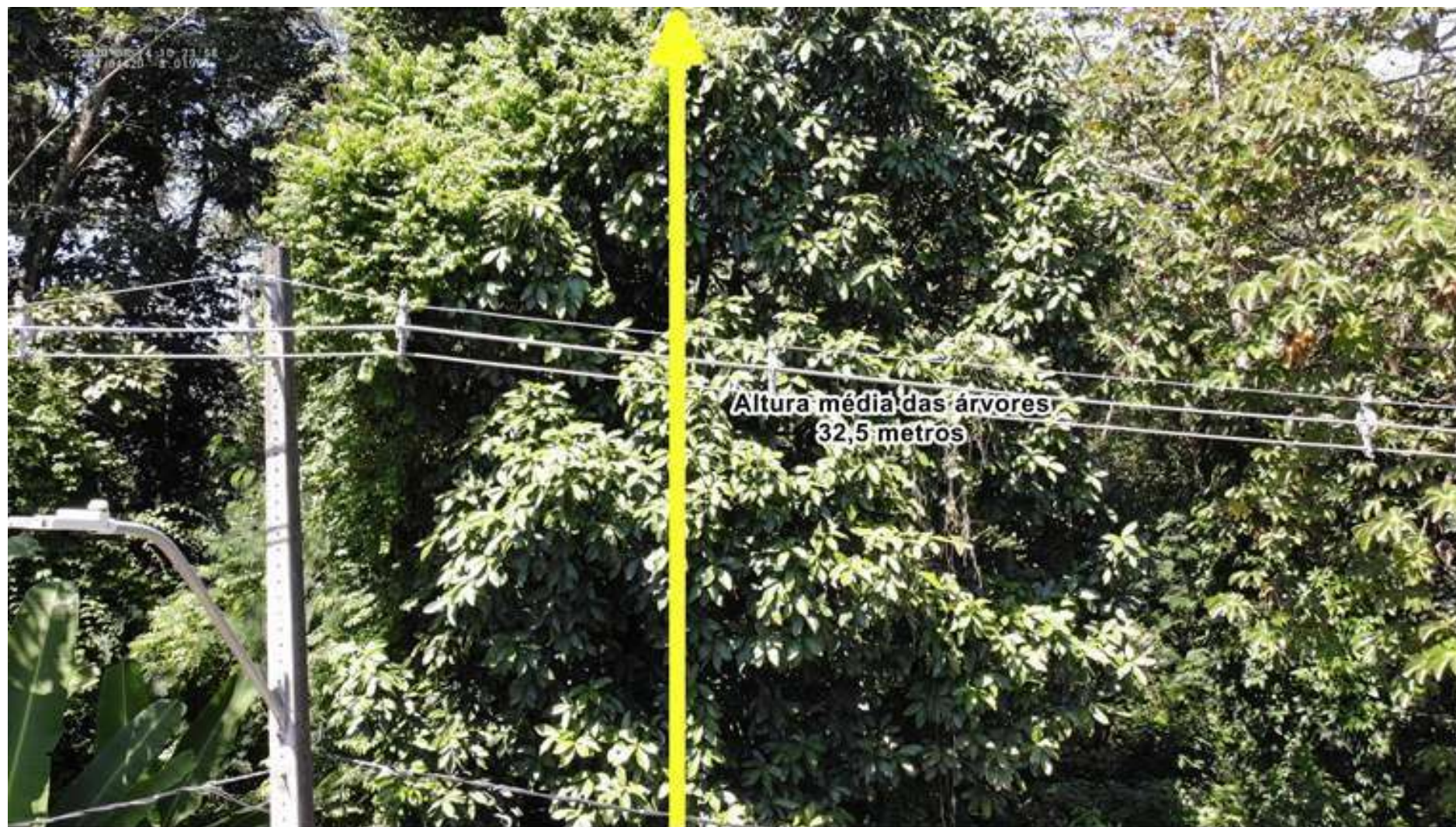
Imagem 28. Monitoramento de Conflito da rede elétrica com a vegetação. Estruturas Vão - 03
