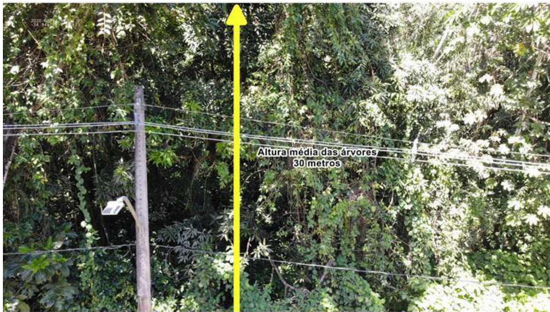
Imagem 30. Monitoramento de Conflito da rede elétrica com a vegetação. Estruturas Vão - 05
