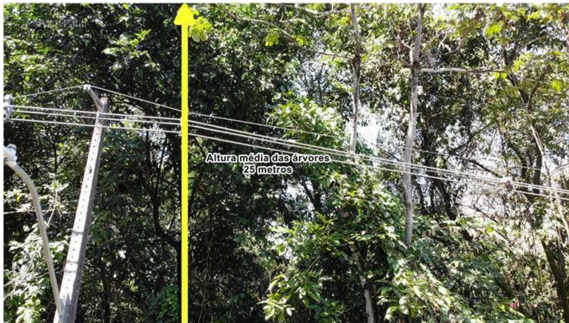
Imagem 31. Monitoramento de Conflito da rede elétrica com a vegetação. Estruturas Vão - 06
