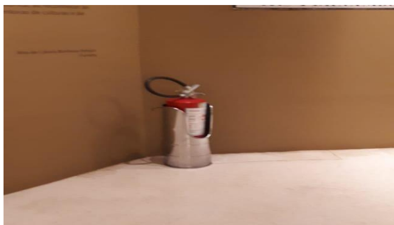
Figura 12 - Extintor de incêndio sem sinalização de piso.
