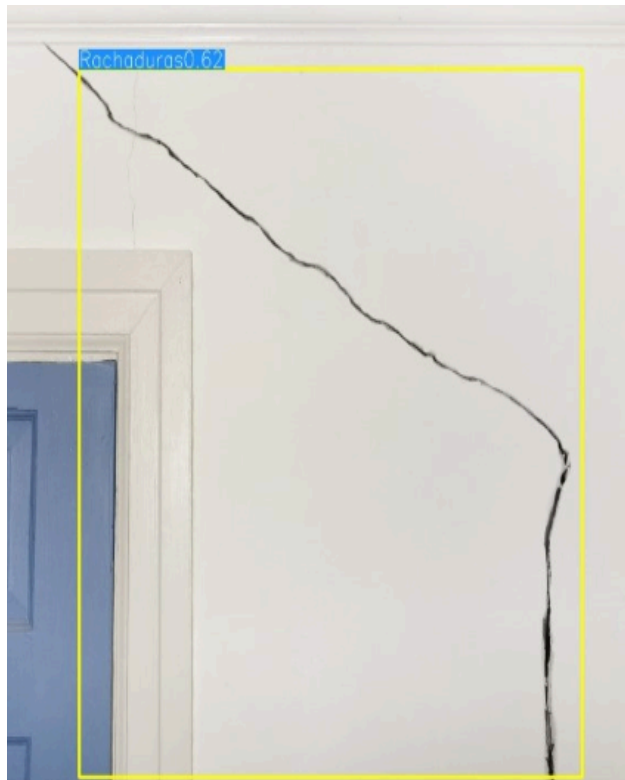
Figura 4 - Bounding box indicando o nível de exatidão na detecção de rachaduras.
