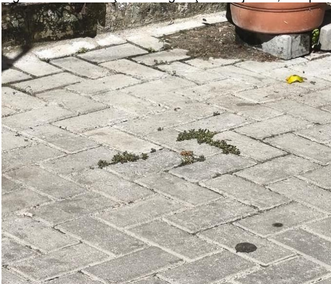
Figura 2 – Proliferação de vegetação nas juntas, comprometendo o intertravamento lateral
