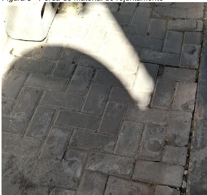
Figura 3 - Perda de material de rejuntamento
