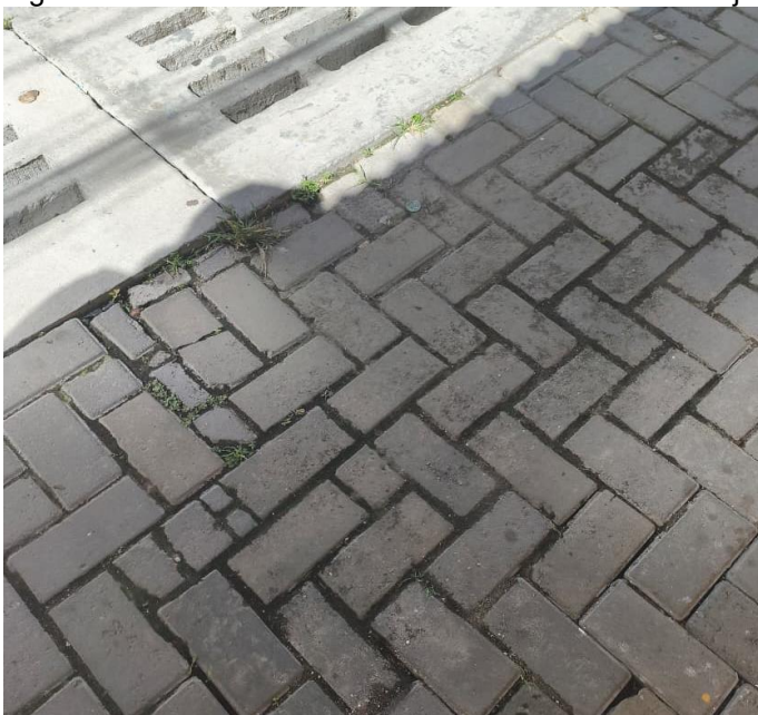
Figura 1 – Afundamento e acúmulo de sedimentos nas juntas do pavimento
