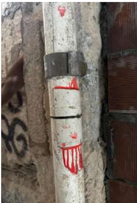
Figura 5 – Prumada de água fria com reparo irregular preexistente.
