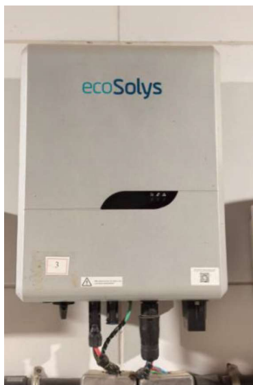
Figura 2 – Inversor fotovoltaico EcoSolys de 5 kW instalado em residência no município de Gravatá-PE
