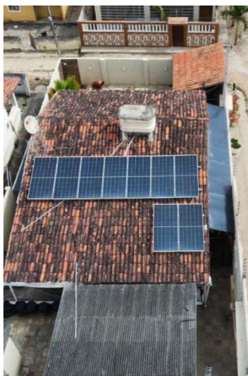
Figura 3 – Módulos fotovoltaicos instalados em residência no município de Gravatá–PE.
