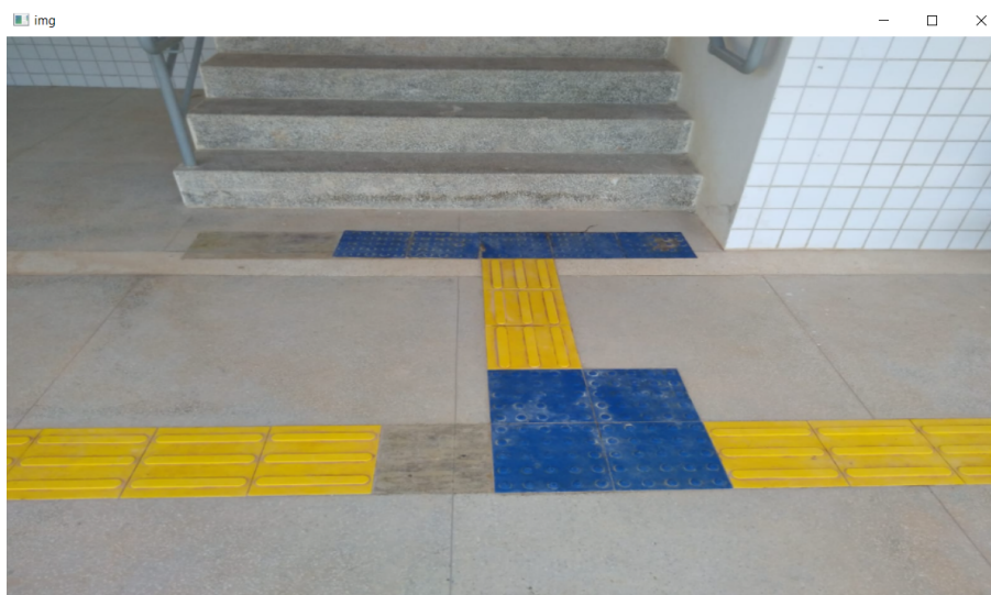
Figura 01 – Falhas em decorrência da falta de manutenção adequada dos pisos táteis.
