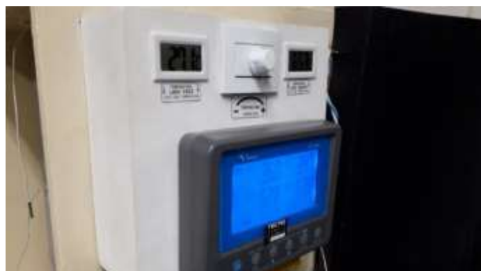
Figura 19 – Quadro de comando e controle
