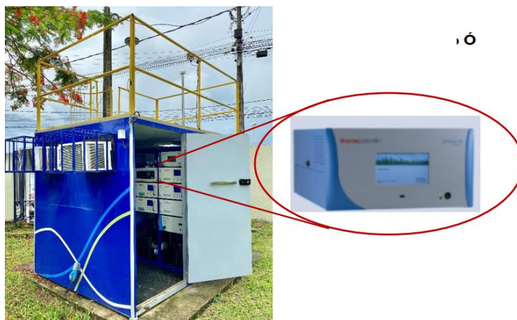
Figura 7 - Estação automática de monitoramento Ipojuca
