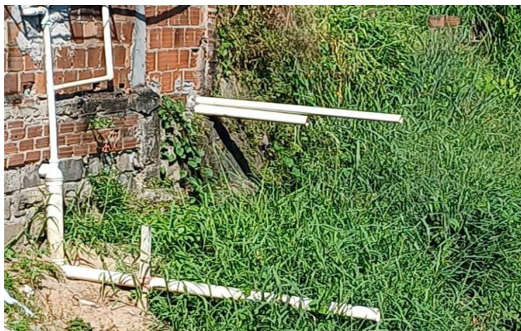
Figura 22 - Tubulações de vaso sanitário e esgotos direcionados para despejo no Rio das Pedrinhas na Comunidade da Baixinha.
