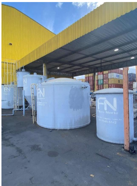
Figura 4 – Estação de tratamento de efluentes
