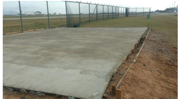
Figura 13: Armação de uma fundação em radier, Base Aérea de Fortaleza, Fortaleza – CE
