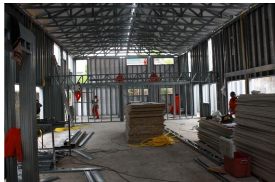
Figura 12: Montagem de uma Casa de Festas com Mezanino, Casa Forte, Recife – PE
