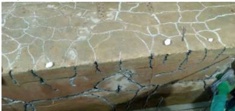
Figura 02 – Mapeamento das fissuras no bloco.
