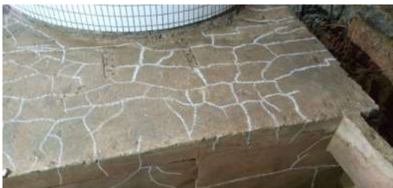
Figura 01 – Mapeamento das fissuras no bloco.
