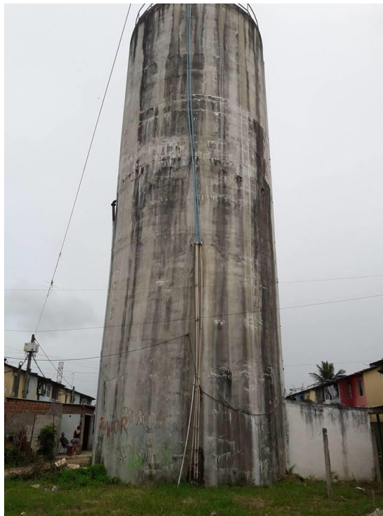
Fotografia 23 – Depósito de água sem funcionar
