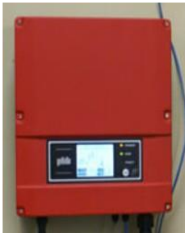
Figura 5 – Inversor Fotovoltaico utilizado para o estudo.
