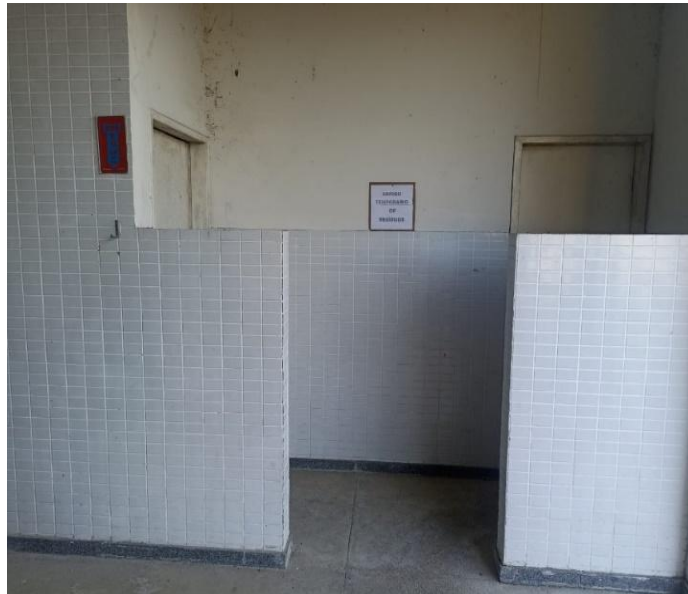
Figuras 22 - Abrigo temporário de Resíduos
