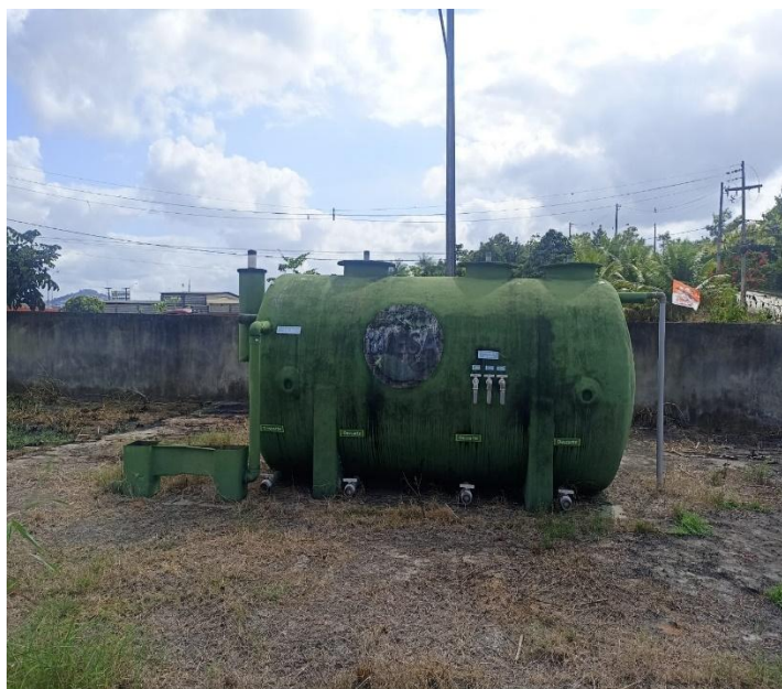
Figura 12 - Unidade de armazenagem de Resíduos biológicos líquidos
