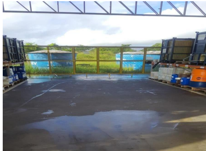
Figura 15: Central de óleos após limpeza
