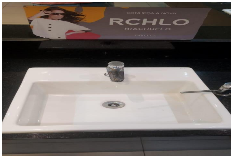
Figura 12 - Torneira do banheiro do Shopping Camará sem nenhum tipo de indução a economia de água ou referência sobre alguma ação ambiental do shopping em relação a água utilizada.
