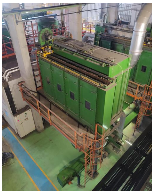
Figura 3.7 – Filtro de mangas FMG 34. Fonte: Autoria própria.
