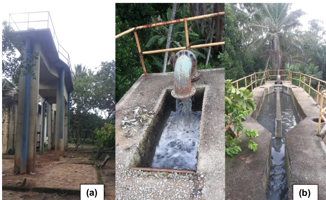
Figura 1 - Captura fotográfica da caixa de área que configura a chegada do esgoto a ETE Rio Formoso/PE: (a) vista frontal e (b) vista superior
