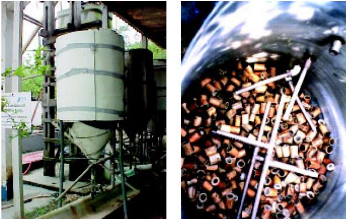
Figura 15 - Vista externa (esquerda) e interna (direita) do UASB
