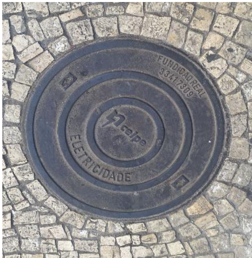
Figura 13 – Tampa de bueiro instalada pela CELPE na Rua Mariz e Barros
