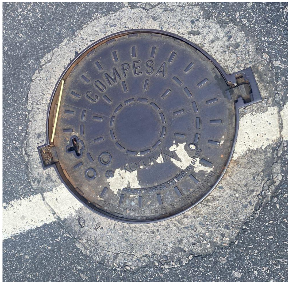
Figura 10 – Tapa de bueiro, instalada na Avenida Alfredo Lisboa pela COMPESA
