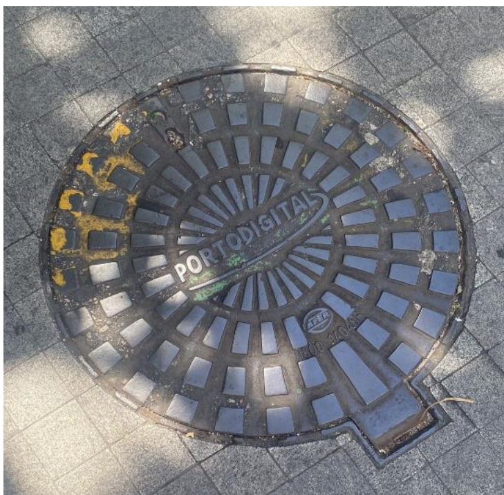
Figura 14 – Tampa de bueiro, instalada na Avenida Rio Branco pela AFER.
