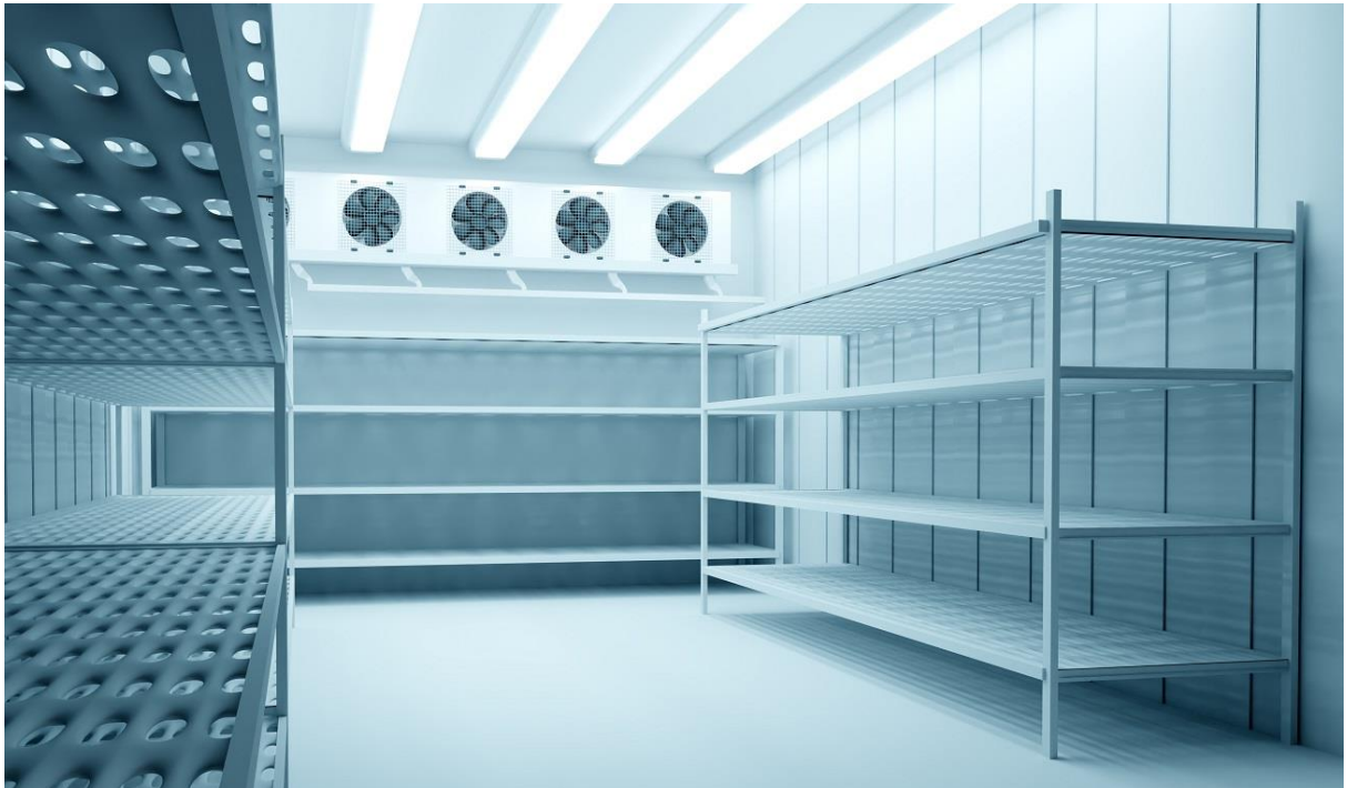
Figura 15 - Prateleiras na parte interna de uma câmara frigorífica
