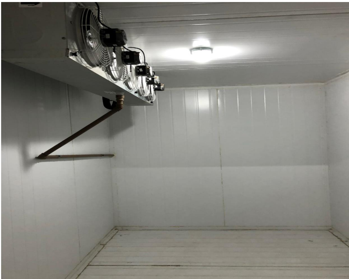
Figura 13 - Tubulação da unidade evaporadora
