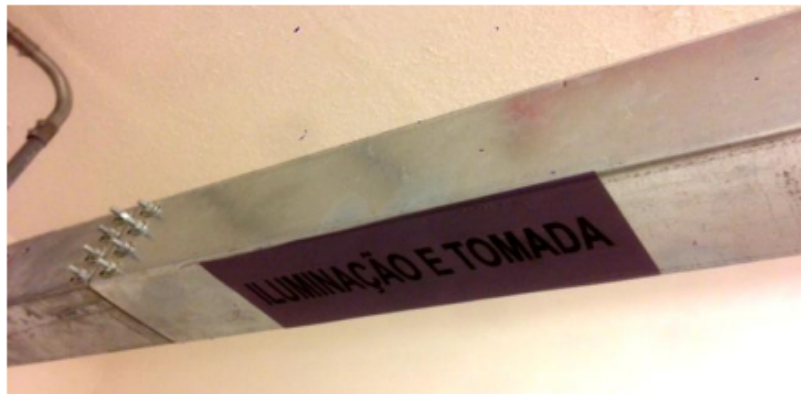
Figura 1 – Identificação dos componentes de iluminação e tomada.
