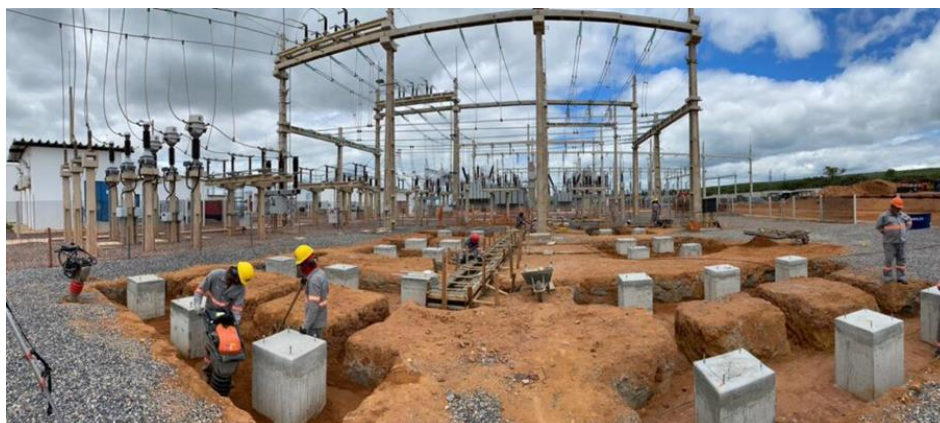
Figura 2.7 – Trecho da Subestação Morro do Chapéu II (2022).
