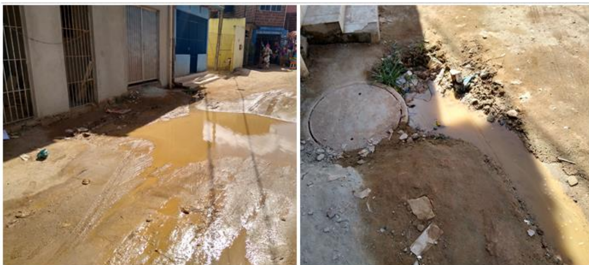
Figura 6 - Vazamento de Esgoto na Rua Um, na praia de Gaibu, via de acesso direto a praia.
