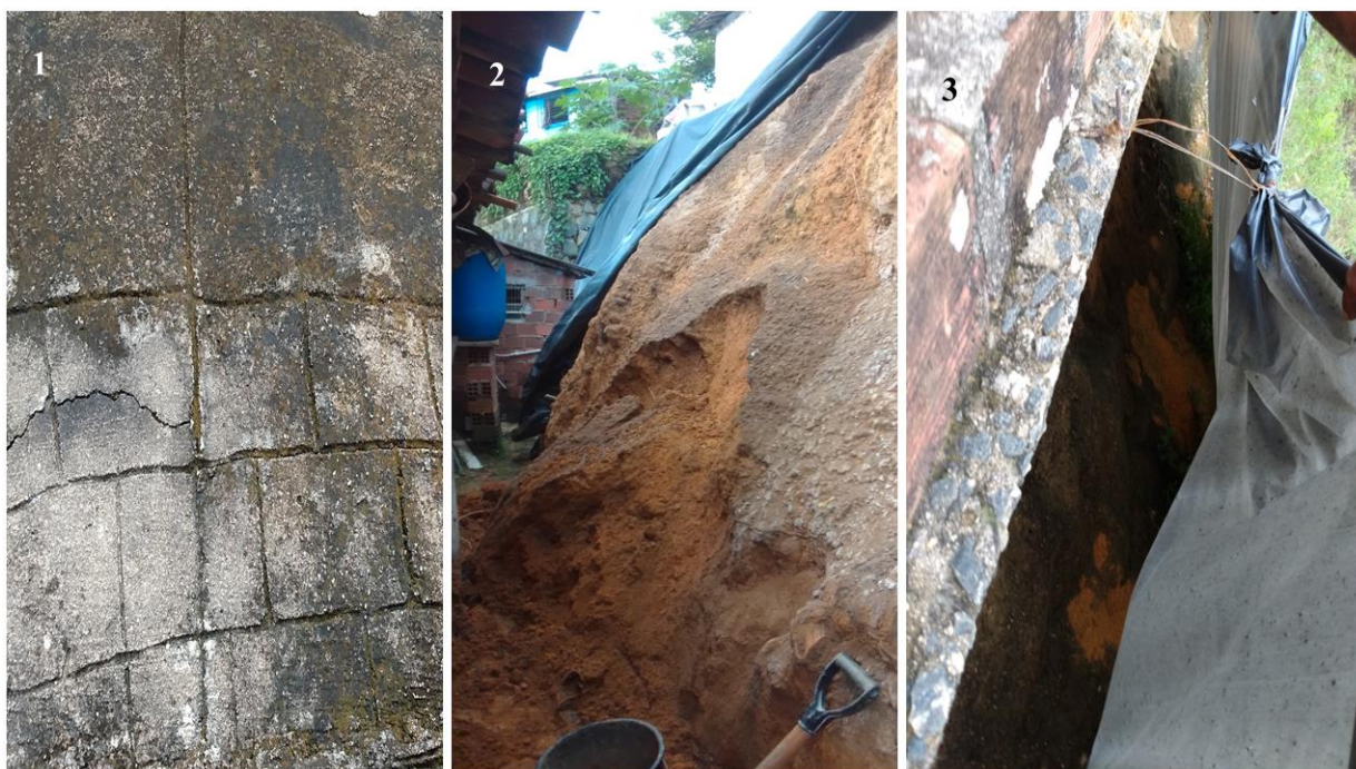
Figura 21: Deslizamento e impactos na infraestrutura das barreiras no Córrego da Jaqueira no setor 10 do Bairro da Linha do Tiro – Recife
